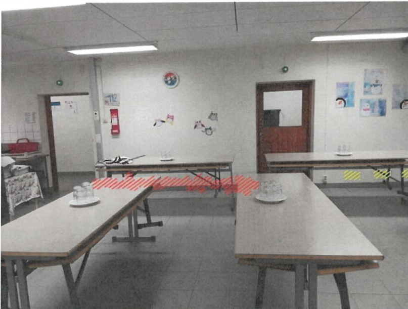
Ruokalan väliseinän alaosa on paikoitellen kostea. Gann 90-141.
